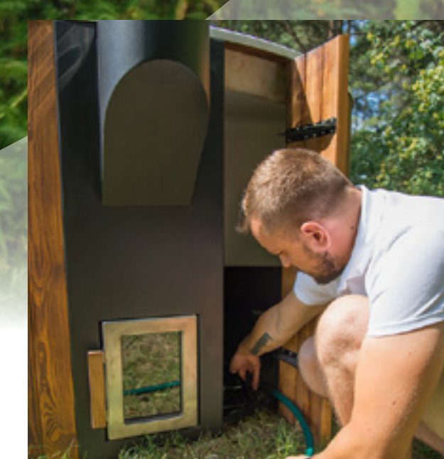
Все технические коммуникации спрятаны внутри конструкции
